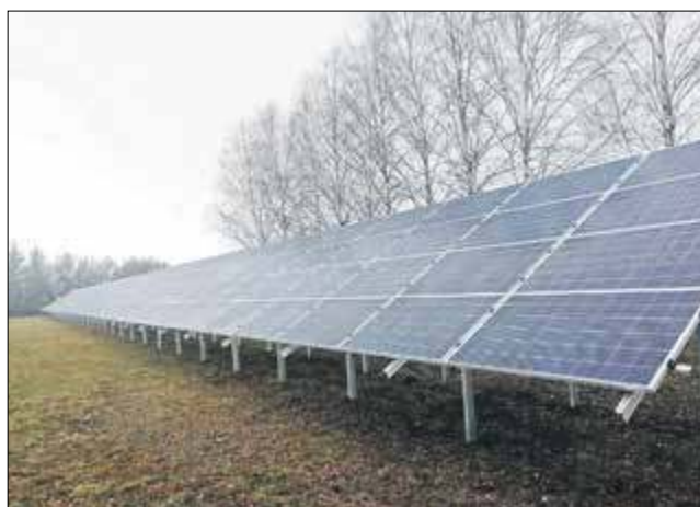
Na potrzeby funkcjonowania ujęć wody zamontowano panele fotowoltaiczne, które pozwolą na znaczne obniżenie kosztów oraz przyczynią się do ochrony środowiska
