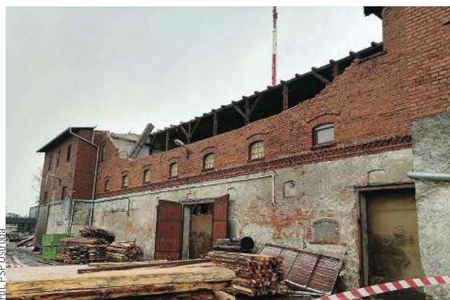
W miejscowości Górka (gm. Ostróda) z budynku magazynowego wiatr zerwał dach na odcinku 20 metrów kw. Zawaliła się też ściana zewnętrzna na wysokości strychu.
