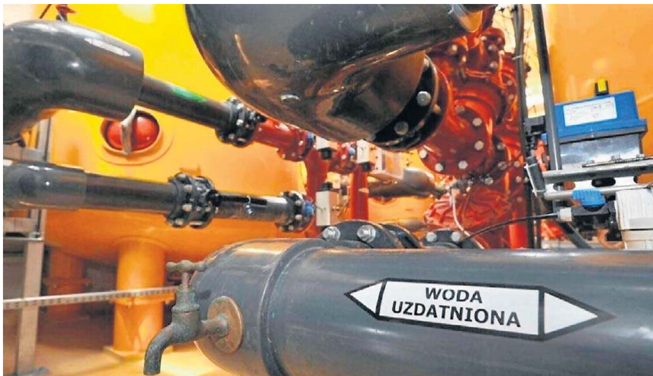
Głównym zadaniem PWiK jest wydobywanie wody, uzdatnienie i dostarczenie mieszkańcom
