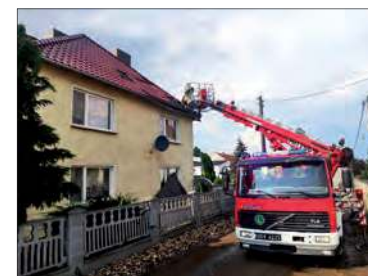
Strażacy zabezpieczają uszkodzony dach budynku mieszkalnego w Nowym Browińcu
