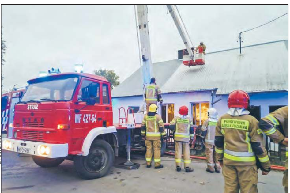
W piątek, 4 października, w Miastkowie Kościelnym doszło do pożaru budynku mieszkalnego. Strażacy zostali wezwani na miejsce około godziny 17:30
