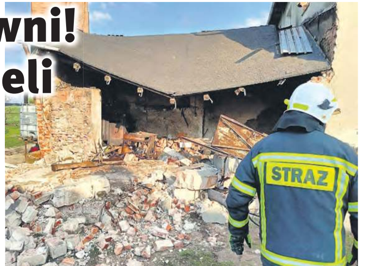
Zawalona ściana i zarwany dach kotłowni, która była dobudowana do budynku. Fot. OSP Bysław
