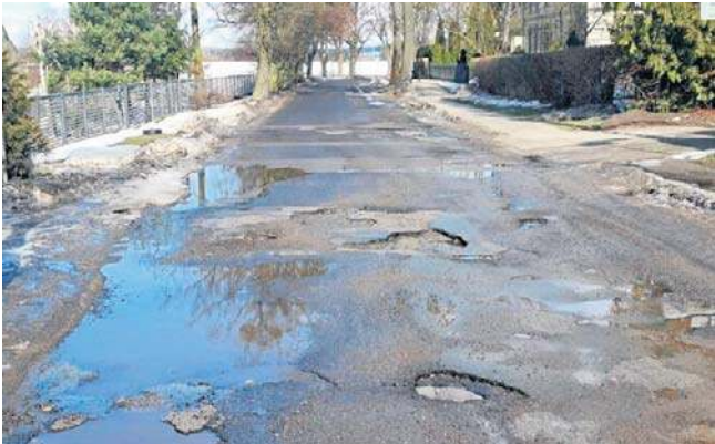
W najgorszym stanie w gminie Skarszewy jest droga powiatowa na ul. Kamierowskiej
