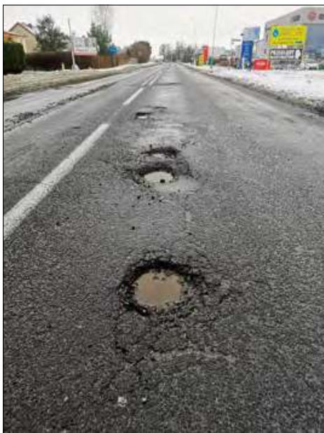
Droga już od dawna wymaga remontu.
