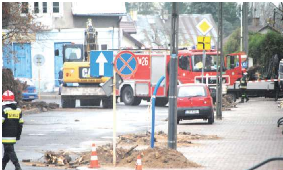
Rurociąg średniego ciśnienia gazu przerwany został przez koparkę, podczas prac związanych z karczowaniem i wycinaniem pni drzew przy ul. Stary Rynek w Opolu Lubelskim
