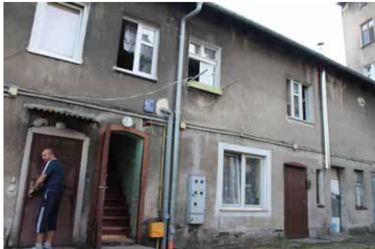
Pan Mirosław od lat zgłasza problemy związane z koniecznością zużycia sporej ilości opału by ogrzać mieszkanie, w związku z nieociepleniem ściany bloku
