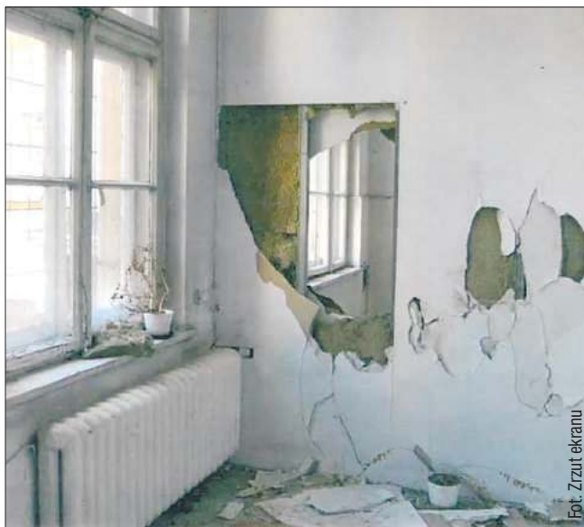
Wnętrze harcówki dzisiaj. Budynek nie jest bezpieczny.
