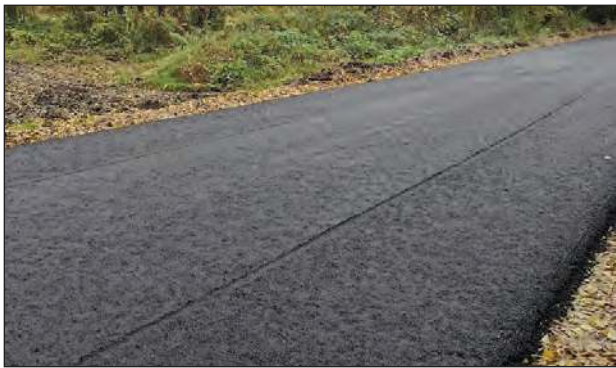
Mieszkańcy od wielu lat starali się o poprawę jakości tej drogi. W końcu się udało
