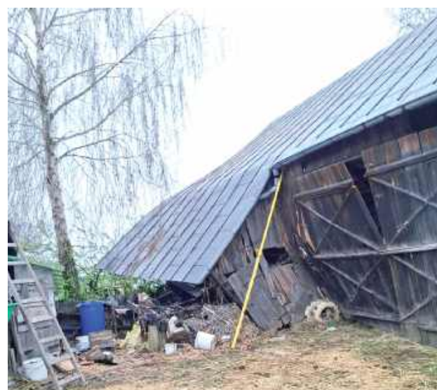
Uszkodzona przez silny wiatr stara stodoła
