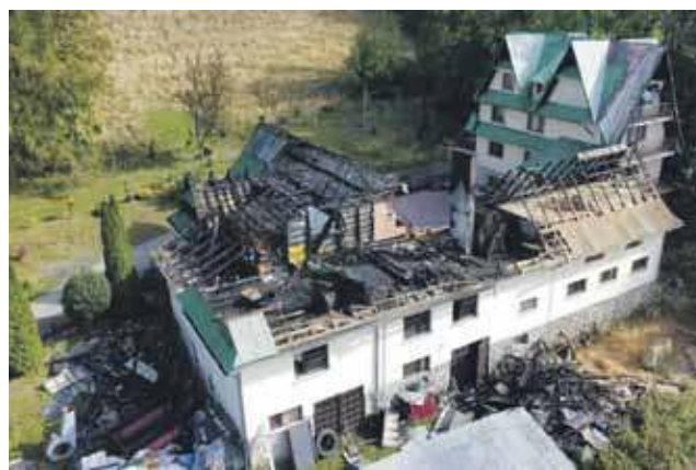
Tak wyglądają zabudowania tuż po akcji gaśniczej.
