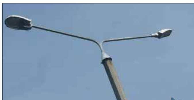
Lampy na zniszczonych słupach
