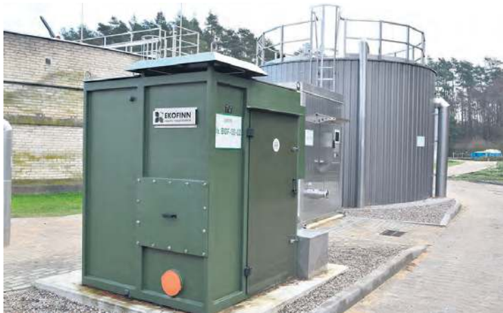
W niewralgicznych miejscach na terenie oczyszczalni znajdują się zbiorniki z bio-filtrem (łącznie 5), które odciągają odory.
