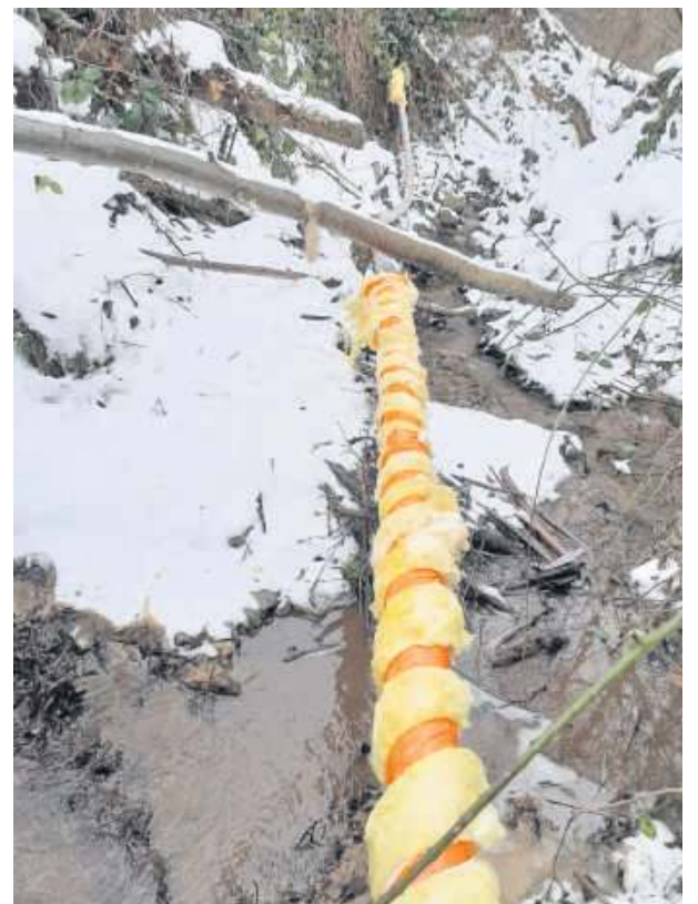
Po ostatniej awarii w taki sposób zabezpieczono rurę
