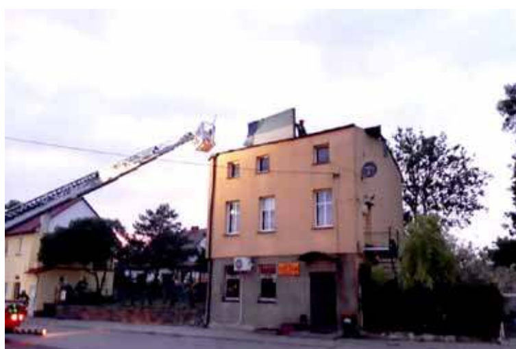
W wyniku sobotniej nawałnicy w Żukowie zerwało kawałek dachu
