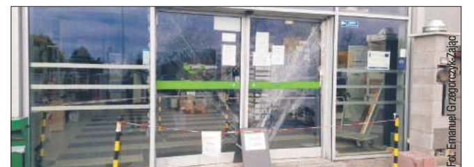
Uszkodzone przez kierowcę drzwi sklepu.
