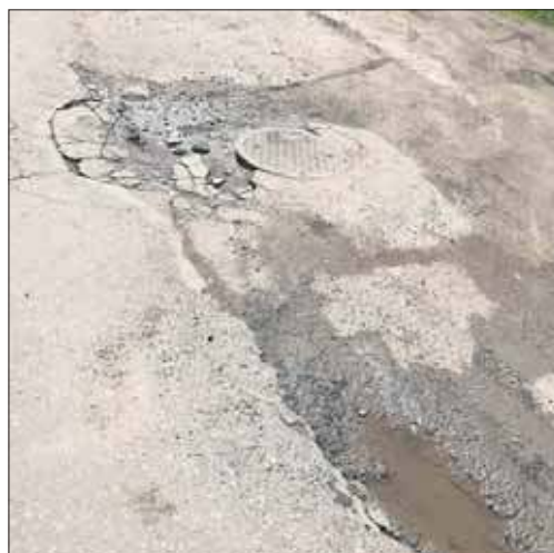
Prośba o naprawę drogi została wysłana do MZDiM
