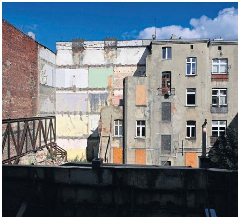
Kamienica przy ul. 1 Maja. Jej część runęła podczas pracy maszyny drążącej tunel. Mieszkańców wyprowadzono do hoteli i innych lokali
