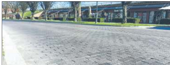
Naprawa nowiutkiej ulicy trwa z przerwami od ponad dwóch lat. I końca nie widać.
