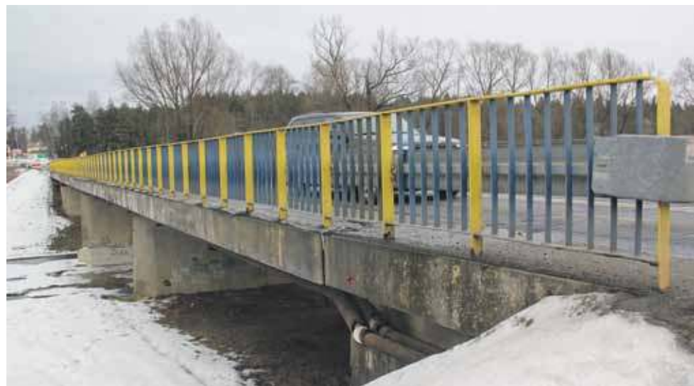
Most w przedłużeniu ul. Ludźmierskiej czeka przebudowa. Inwestor będzie jednak musiał zbudować zastępczą przeprawę.
