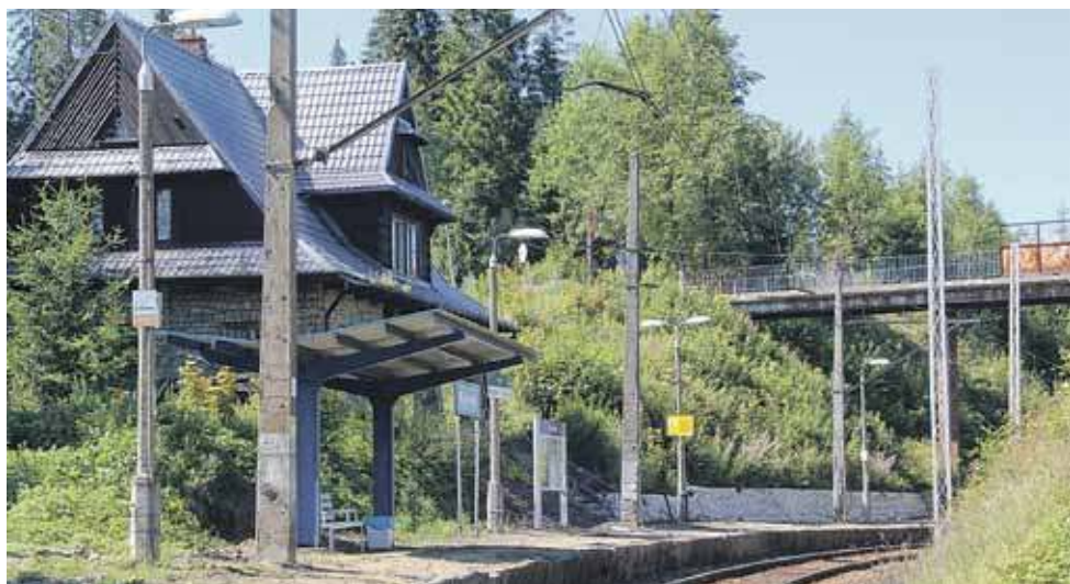
Zaniedbany budynek stacji PKP czeka na remont.
