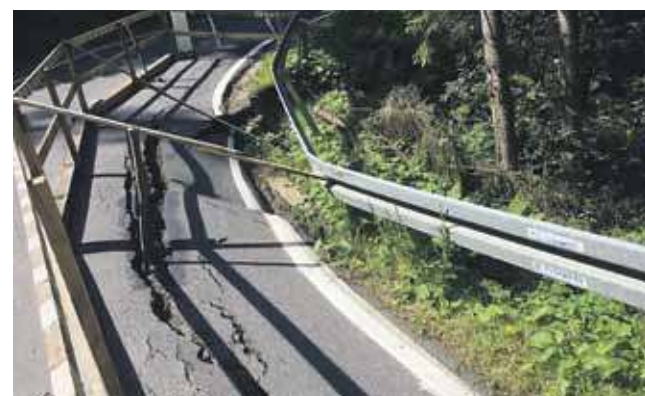
Zniszczona droga w Knurowie.
