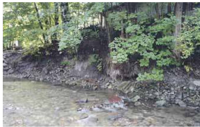
Stan brzegu Potoku Młyniska na Kasprusiach jest w fatalnym stanie.
