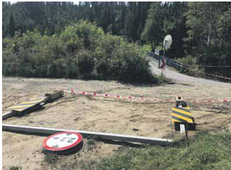
Zniszczone oznakowanie na moście w Pyzówce.
