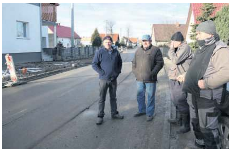
Mieszkańcy Łojowic i sołtys Jan Kardas (drugi z lewej) twierdzą, że remont chodników został źle wykonany
