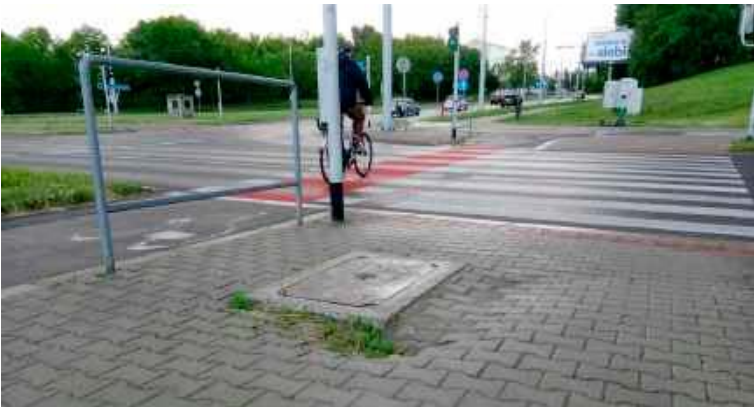
Zapadlisko przy studzience niebawem zostanie naprawione
