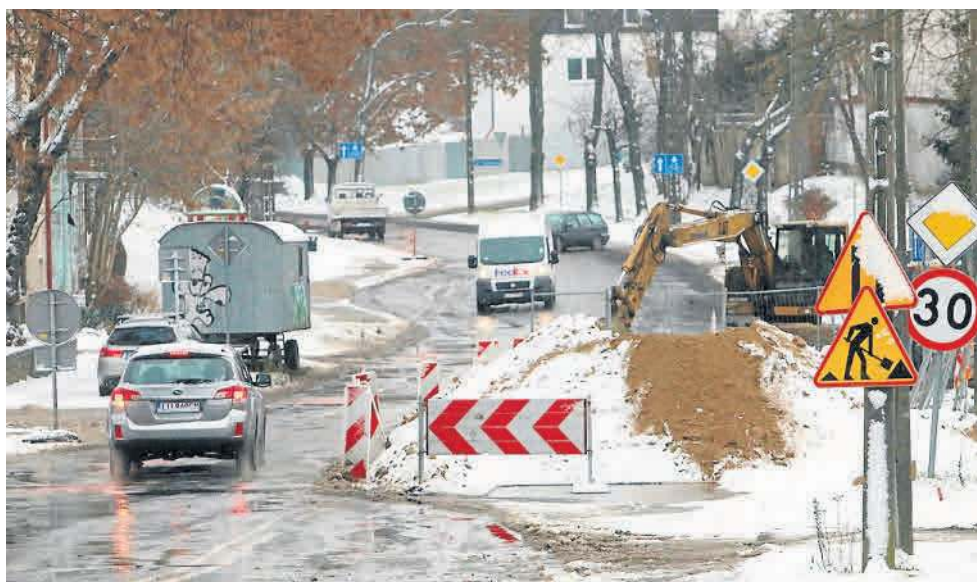
250 mln zł na drogi gminne i powiatowe w naszym regionie pozwoli na wyremontowanie dziesiątków kilometrów. Koszt remontu 1 kilometra drogi waha się od 1 do 8 mln złotych
