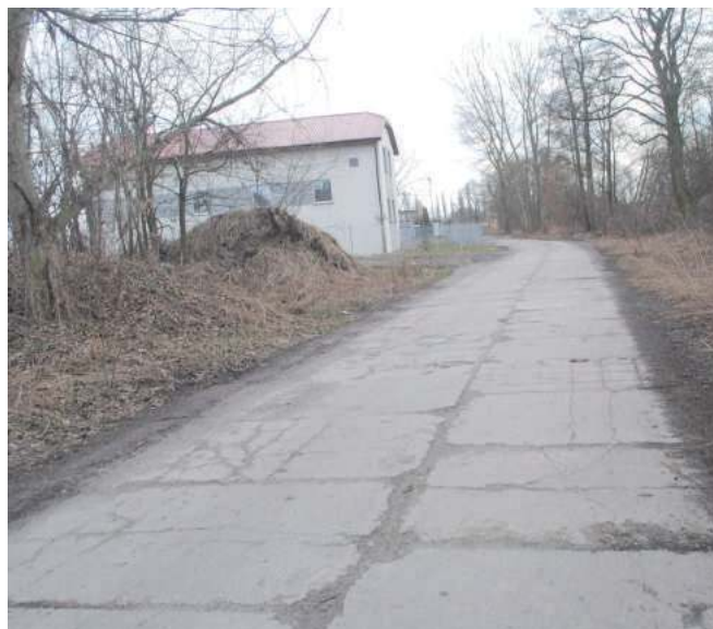
Odcinek od siedziby PGK do ul. Wierzbowej wymaga remontu. W tym roku miasto jednak nie ma środków na ten cel
