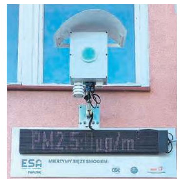
Czujnik smogu oraz tablica LED na elewacji szkoły.
