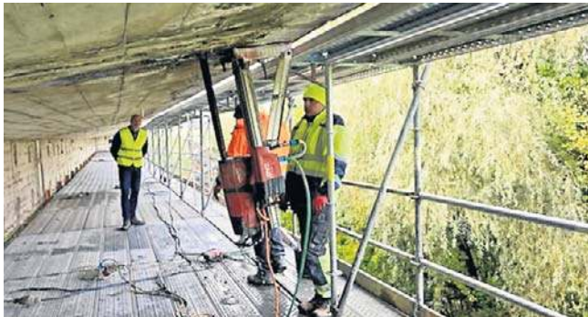
Specjalistyczne badania wykazały zły stan techniczny betonu wspornika zapory
