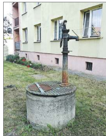
Studnia kopana przy bloku Krakowska 16 zostanie naprawiona.
