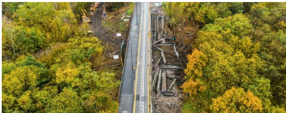
Podczas bardziej zaawansowanych prac rozbiórkowych okazało się, że stan techniczny zakrytych wcześniej elementów konstrukcji stwarza zagrożenie – informuje ZDM | fot. Zdm.waw.pl/d
