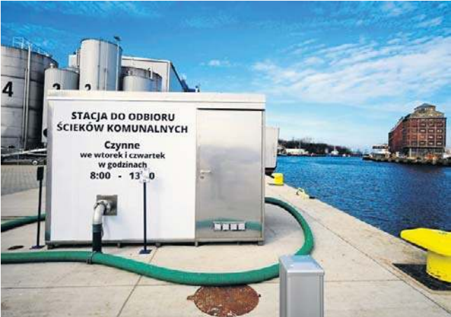
Nowoczesna stacja odbioru ścieków komunalnych
