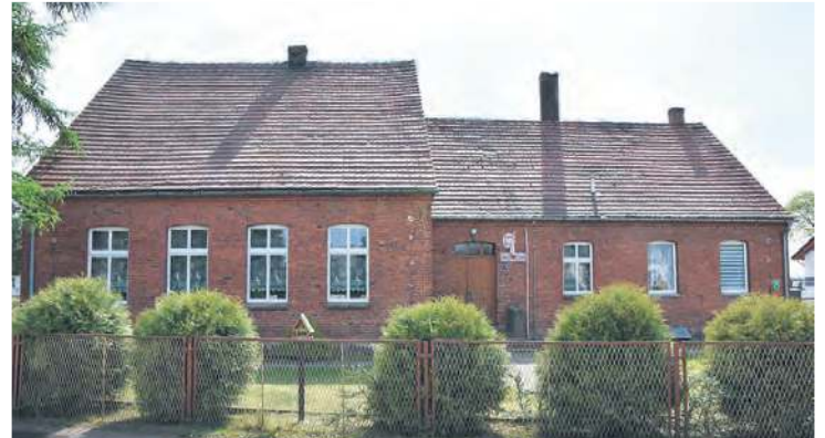
Według ekspertyzy budowlanej z 2019 roku obiekt, w którym znajduje się szkoła filialna w Suchej, powinien przejść gruntowny remont. Koszt? Nawet 600 tys. zł.
