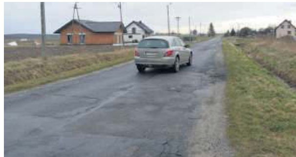
Droga w Przewornie czeka na remont
