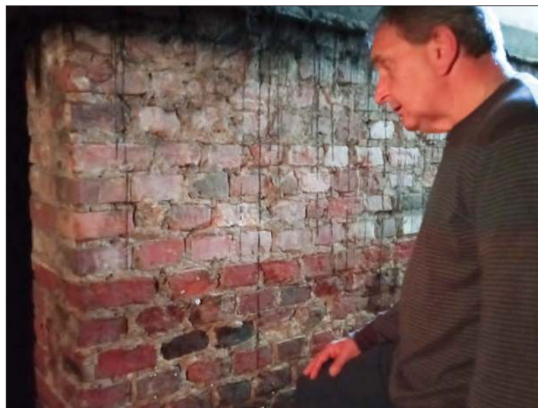
➤ Nawet po kilkunastu dniach po wypompowaniu wody, na ścianach piwnicy dobrze widać dokąd sięgał jej poziom. Krzysztof Kultys uważa, że ta wilgoć będzie przechodziła na wyższe kondygnacje
