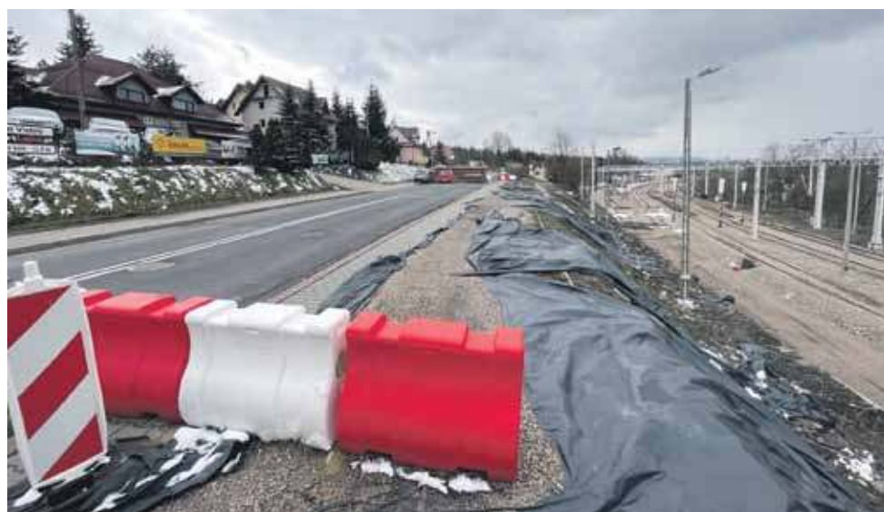
Pęknięcia w drodze ciągle się powiększają.
