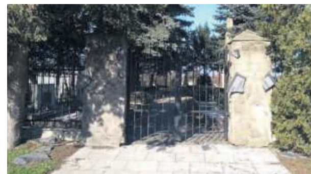
Rozbite tablice zainstalowane były na obu słupkach
