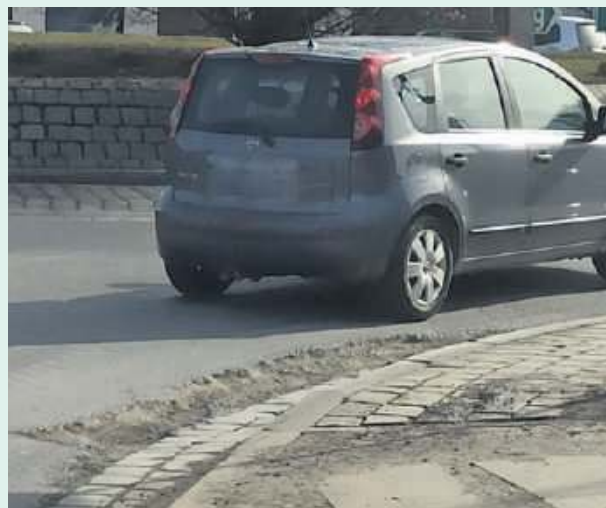
W niektórych miejscach na strzelińskim rondzie pojawiły się duże ubytki w jezdni
