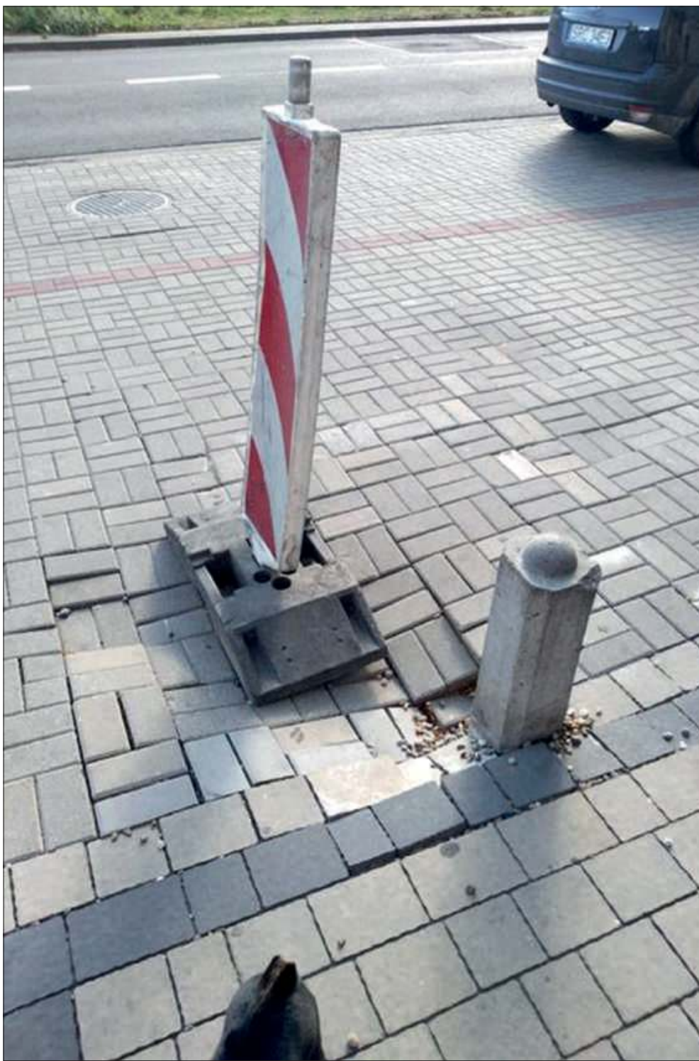
Przeprowadzenie monitoringu sieci kanalizacyjnej ma pozwolić na ustalenie przyczyny zapadania się fragmentu chodnika dla pieszych przy ul. Batorego w Raciborzu
