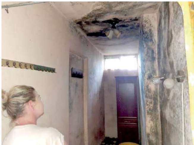
Dach na przybudówce domu przy ul. Łąpiguz 74 jest nieszczelny. Lokatorzy skarżą się na wilgoć, grzyb, brak prądu w sieni
