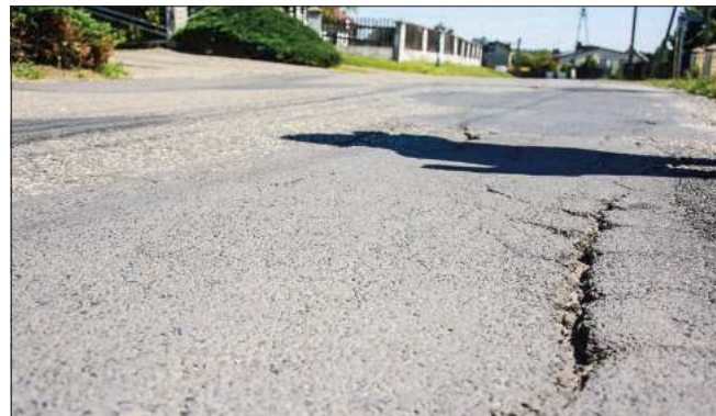
Nawierzchnia ul. Wyzwolenia pokryta jest licznymi dziurami, pęknięciami i zapadliskami
