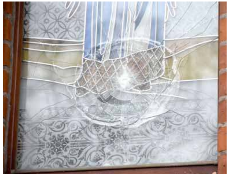
Na zdjęciu widać wyraźnie wgniecenie witraża po uderzeniu kamieniem
