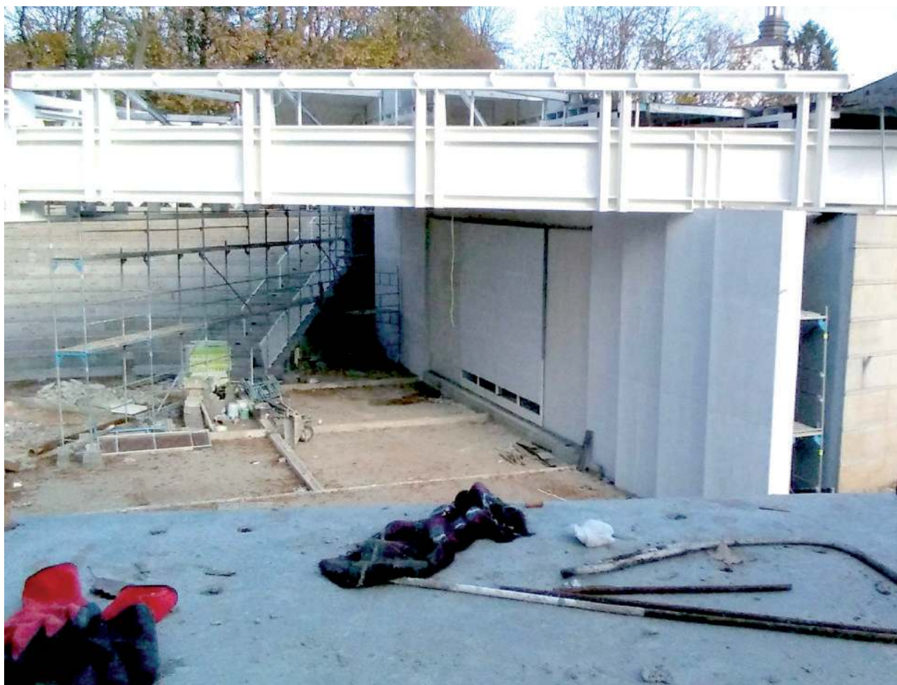
Na budowie widać bałagan. Wykonawca i inwestor czekają na przeprojektowanie
