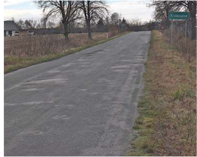
Droga jest w złym stanie technicznym. W końcu doczeka się remontu
