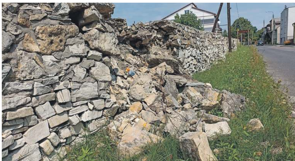
Zniszczony mur cmentarza żydowskiego
