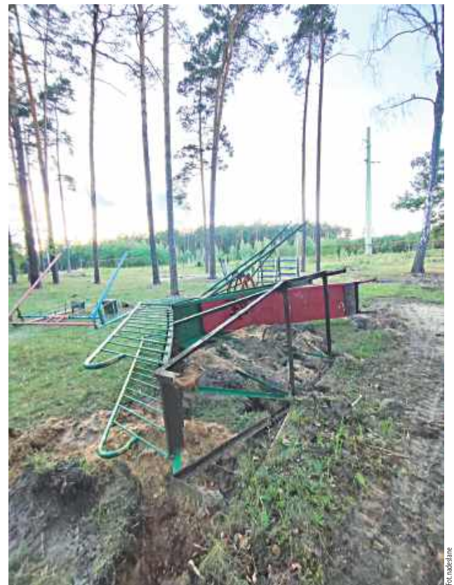
Czytelnik zwrócił uwagę na niezabezpieczone elementy
