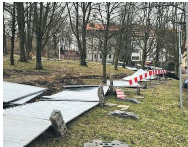
Ogrodzenie budowy jest powalone, ale mało kto się tym przejmuje
