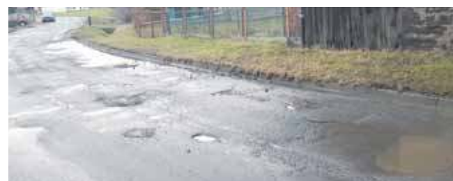
Nawet tam, gdzie droga jest w „lepszim” stanie, ubytki mocno dają się we znaki
