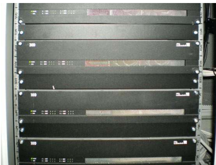
System główny oraz tory odsłuchowe zasilane są z 4 wzmacniaczy d&b (2 x 30D i 2 x 10D) zainstalowanych w amplifikatorni znajdującej się pod sceną.
