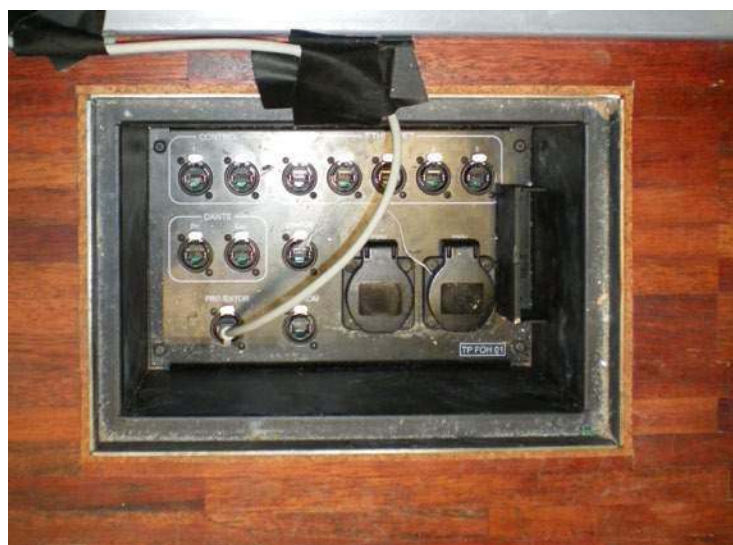
Oprócz reżyserki projektant systemu przewidział również inne miejsca tymczasowej lokalizacji konsoli – na środku głównej widowni oraz na balkonie – gdzie zostały zamontowane panele udostępniające gniazda zasilające oraz wszystkie niezbędne porty przyłączeniowe.
