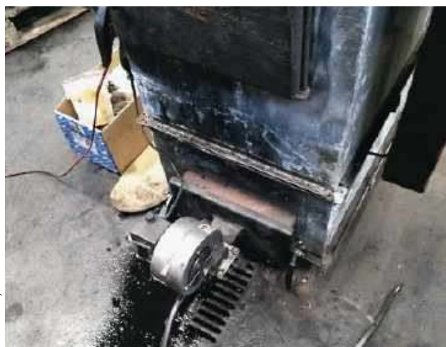
Piec, w którym właściciel spalał olej silnikowy
